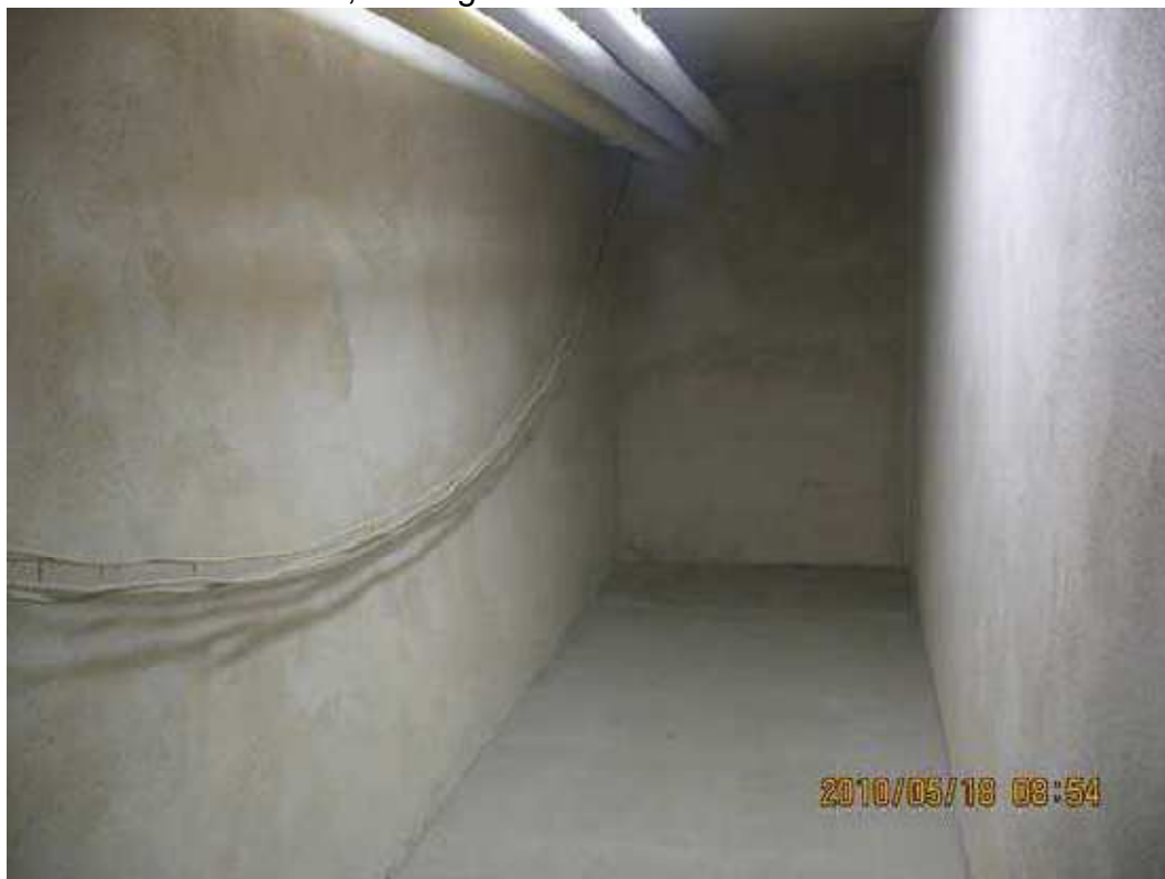
Zustand: 18 März 2010, ein Jahr danach. Nach verregnetem Herbst und dem Jahrhundert-Winter (Monatelanger Schnee und entsprechend hohes Tauwasser)
