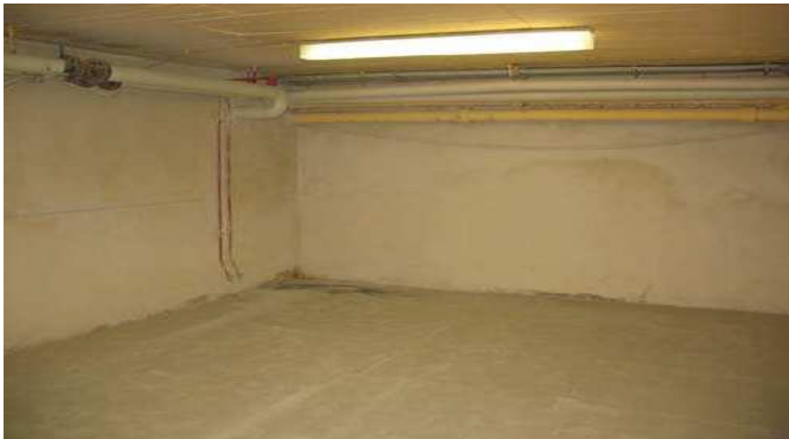
Bild 8: Zustand 18. Mai 2010 Kellerwände und der Boden, Ausschnitt des großen Kellerraumes
