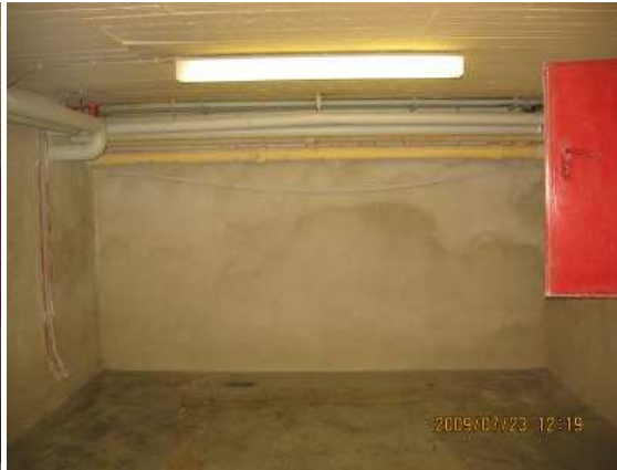
Bild 7: Auf dem nassen Boden wurde aerodurit® Mikroporenestrich verlegt. 10 Tage nach Putzauftrag und Estrichverlegung ; alles fast trocken
