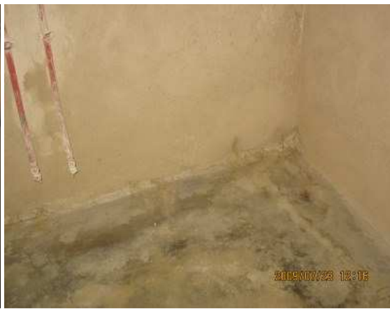
Bild 5: Boden wieder voll gelaufen
