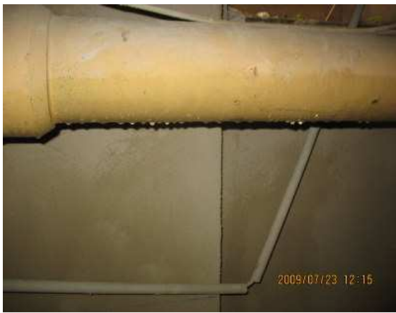
Bild 4: Luftfeuchtigkeit über 85% Es kondensiert an den Rohren
